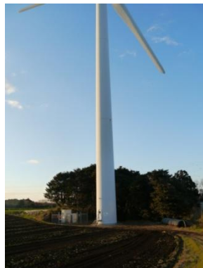
写真 1 風力発電機の設置状況
