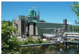
図3. 大沼地熱発電所
